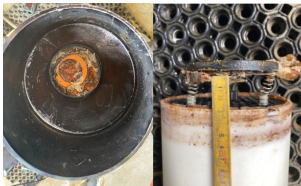
Merker i kannister indikerer at vann har stått over tid 6cm opp fra bunnen.
